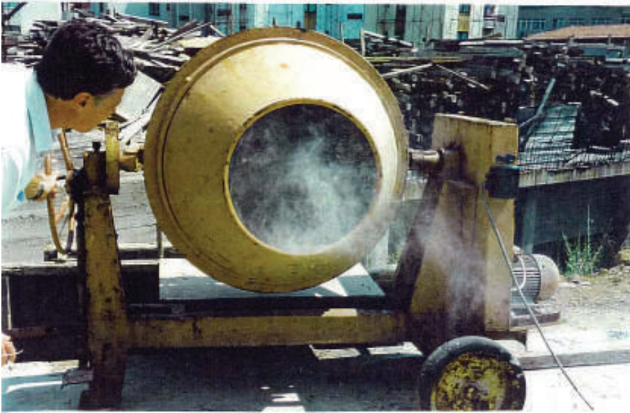
Resim 3.15. Kuru Alçının Kuru Toprakla Karışımı Sırasında Yaşanan Problemler Picture 3.15. Problems Encountered While Mixing Dry Gypsum with Dry Soil
