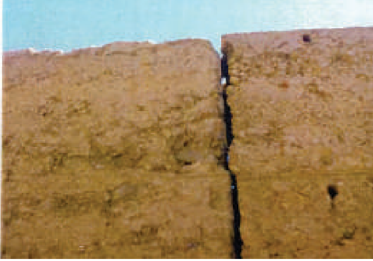
Resim 3.23. Farklı Zamanlarda Dökülen Duvarlardaki iş Derzi Problemi
