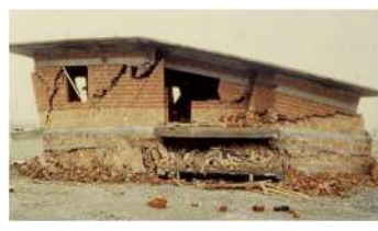
R4 Köşegen çatlak
